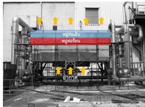
รูปที่ 1 อุปกรณ์แลกเปลี่ยนความร้อน
